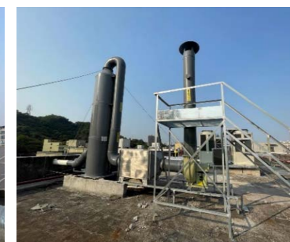
喷淋塔废气处理设施
